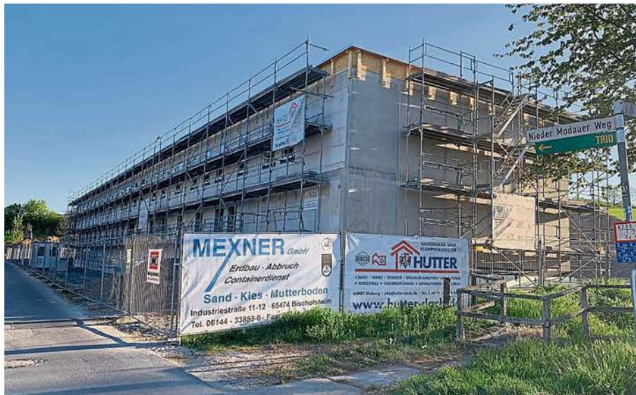
Der Bau der neuen Polizeistation in Ober-Ramstadt schreitet trotz Corona-Krise gut voran. Derzeit werden die Fenster eingesetzt und das Dach gedeckt.
